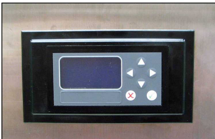
Figura 22: Instalação do higrômetro com placa adaptadora - frontal
