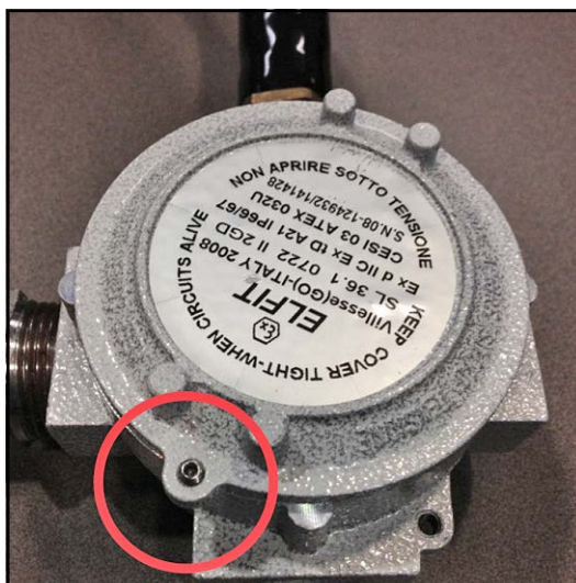
Figura 15: Tornillo de fijación de la caja de empalme
