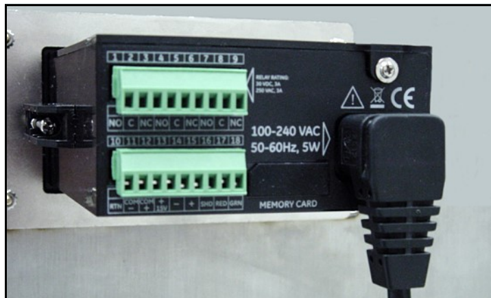
Figura 32: El cable de alimentación de CA instalado
