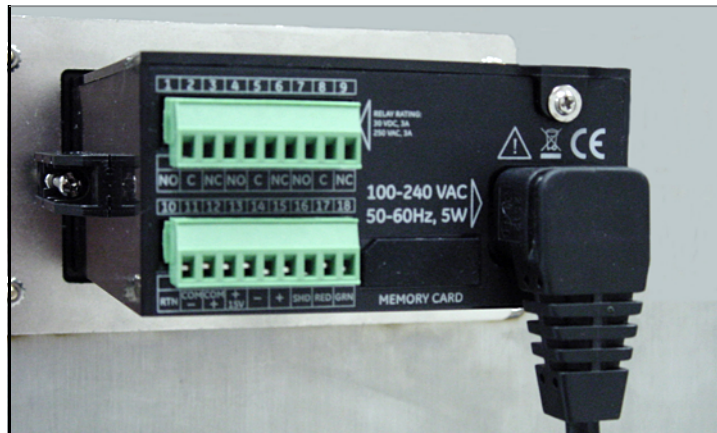
Figure 33: Câble d'alimentation CA branché
