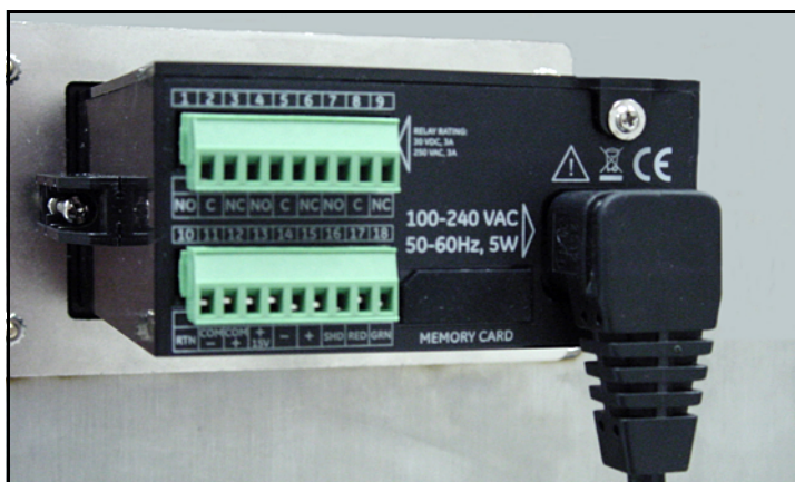
Figure 32: De geïnstalleerde AC-voedingskabel
