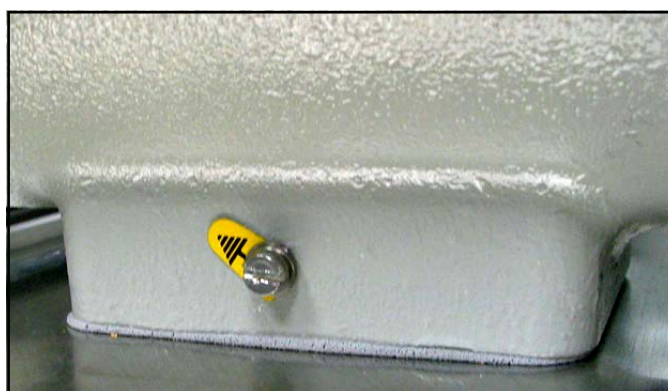
図 31: アース接続部
