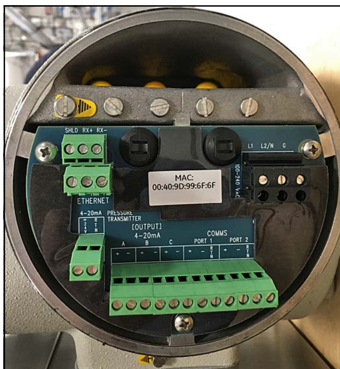
図 25: 配線端子ブロック
